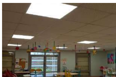
Passage en LED Ecole de Auve
